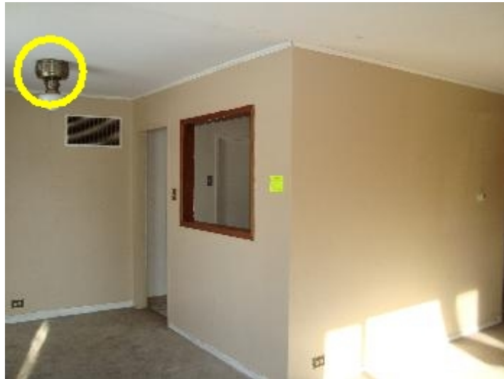
fan blades missing
